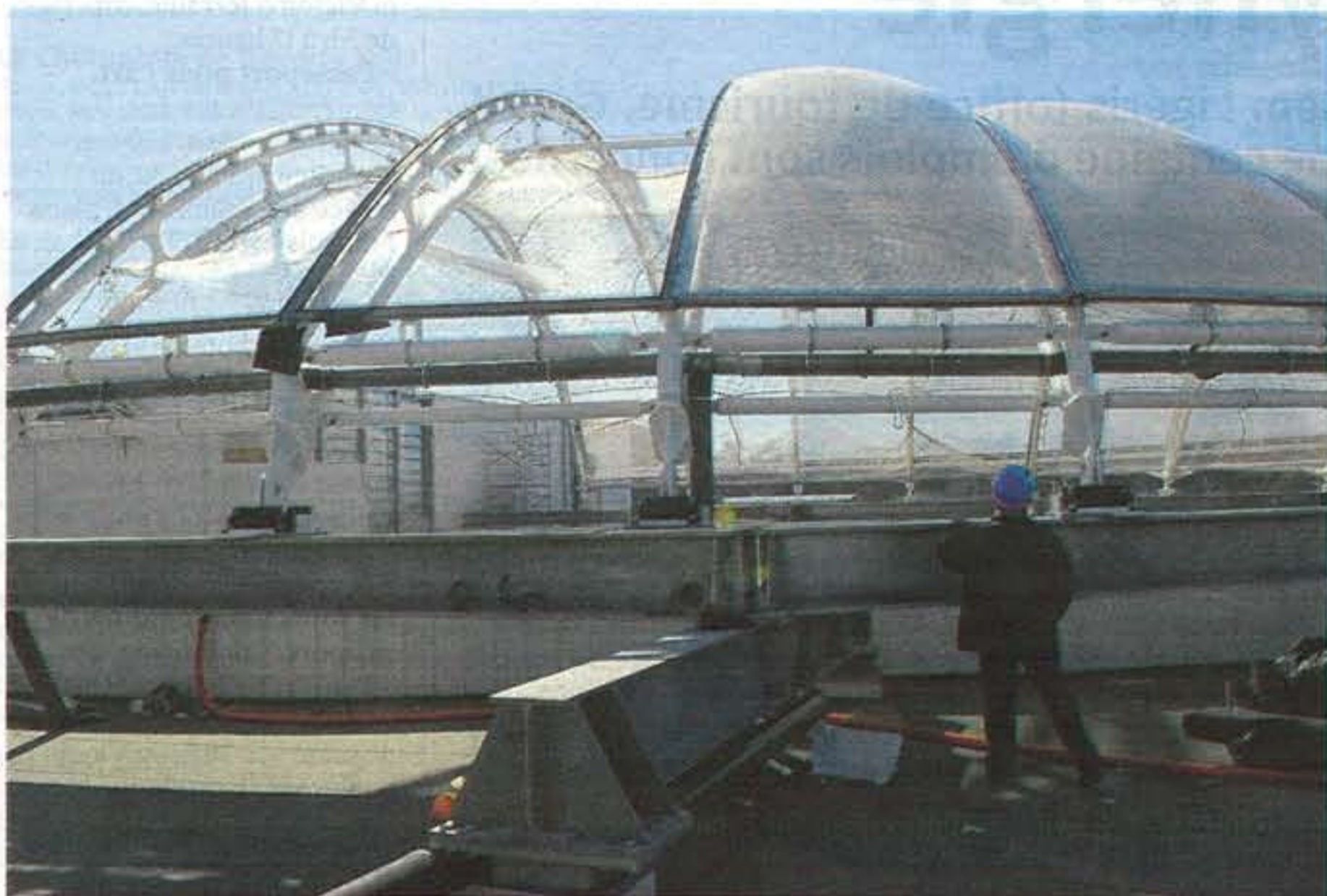
La toiture translucide, réalisée en ETFE (éthylène tétrafluoroéthylène), s'étale sur 5.000 m 2 . Une membrane anti-moisissures fonctionne grâce à une circulation d'air.
