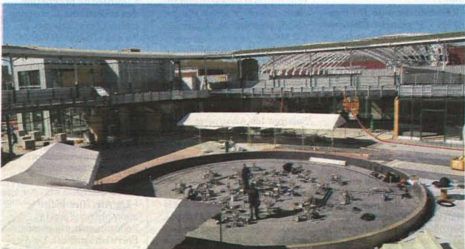
Le grand bassin central sera entouré de terrasses : un espace aménagé pour créer une atmosphère.
